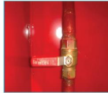
วาล์วเปิด - ปิดน้ำ
