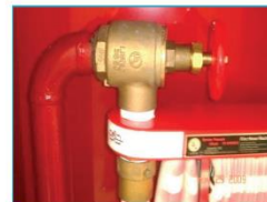
วาล์วเปิด - ปิดน้ำ
